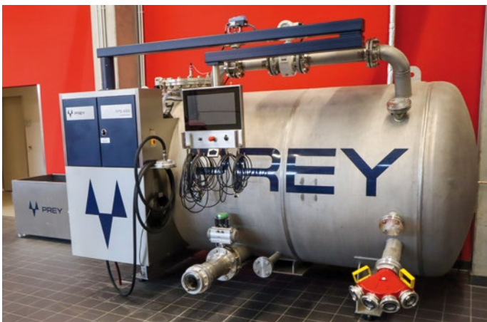
Pumpenprüfstand: Hier werden Feuerwehropumpen gemäß DIN EN 1028 Teil 1 und 2 geprüft. Die Prüfung von Feuerwehrriesel- und von Tauchpumpen ist möglich.
